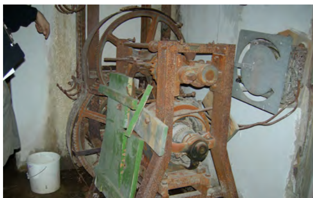
I 2007 var kasematten fyldt med indtrængende vand.
